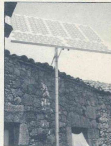
Energía solar fotovoltaica. INSPESO.
